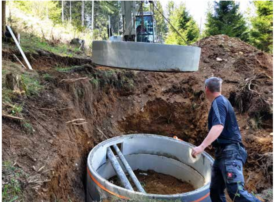
Die Reduzierstationen im Kraßwald und bei der Angerlewegbrücke bestehen aus 3 Stk Betonschachtringen, Konus und Deckel - Einbauhöhe von 220 cm. Durch diesen Schacht verläuft der Abwasserkanal DN 150 mm, sowie die Trinkwasserleitung aus PE-Rohren 110 mm Außendurchmesser.
