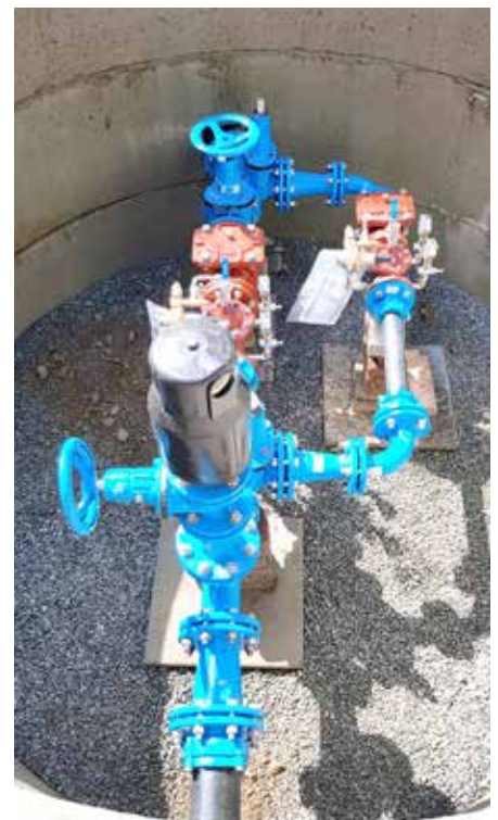
Die Anlagen wurden von der Firma Hawle auf einen Eingangsdruck von 9,00 bzw. 14,00 bar eingestellt. Der Ausgangsdruck wird auf ca. 2,50 bar reduziert.
