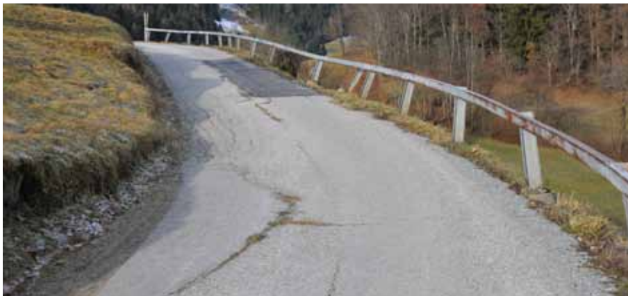
Auch der Wölfeleweg wäre längst schon ein Sanierungsfall. Da die Weganlage aber bereits eine Schwarzdecke aufweist, müssen vorerst einmal die Schotterwege zeitgemäß generalsaniert werden. Mit kleinen „Flickarbeiten“ wird der Wölfeleweg wieder befahrbar und verkehrssicher gemacht.
