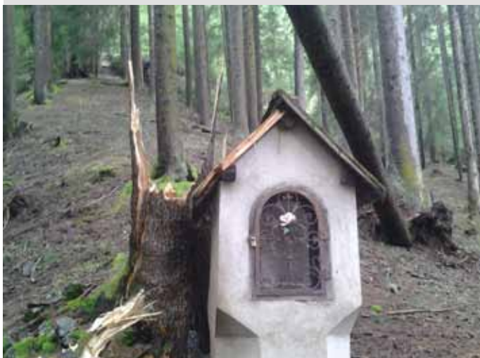
Schäden durch Windwurf: Das Gasser-Stöckl hatte bei diesem Ereignis nur eine „leichte Schramme“ abbekommen. Es ist bereits längere Zeit schon etwas verwaist.
