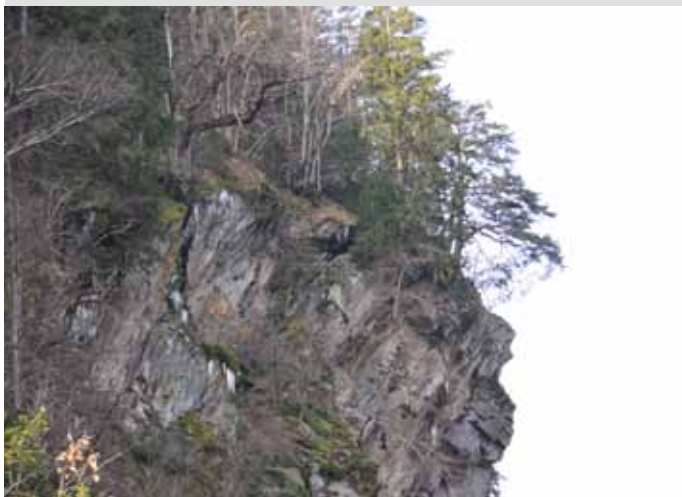
Die Felswände oberhalb der Schlaitner Aue entledigen sich immer wieder von Gesteinsmassen. Die Gefahr an der Angerlewand ist auch für den Laien erkennbar.
