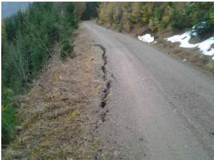
Risse am Göriacher Almweg - die Holzabfuhr musste vorübergehend eingestellt werden. Eine aufwendige Sanierung steht bevor.
