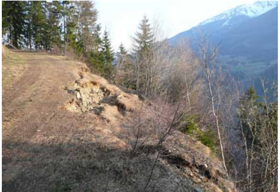
Beim Daberweg ist im Frühjahr abschnittsweise die talseitige Mauer abgebrochen. Eine Trockensteinmauer drohte abzurutschen und gefährdete das darunterliegende Gemeindegebiet von St. Johann i. W.. Auf eine Länge von insgesamt 100 lfm bauten Bedienstete vom Maschinenring Lienz gemeinsam mit der Firma Mariacher ca 2000 m 2 Geogitter ein und sicherten so wieder die Weganlage. Die Kosten für diese Sanierung wurden über die Bezirksforstinspektion finanziert. Die Gemeinde hat einen Anteil von € 2.000,00 zu leisten.
