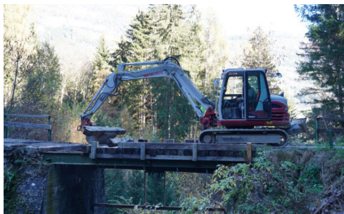
Die Bedienung der Zischgerbrücke wurde zuletzt im November 2012 samt Geländer erneuert. Bereits im Vorjahr mussten wieder einzelne Dielen ausgetauscht werden.
