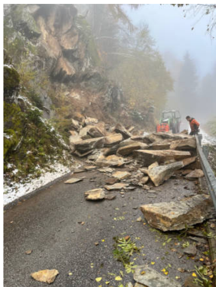
Der massive Felssturz musste mit schwerem Gerät entfernt werden.
