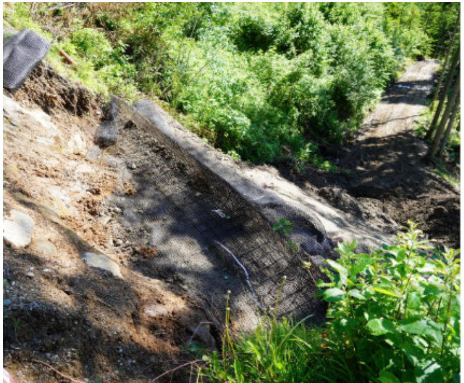
Aufgrund von Absatzungen und Vermurungen waren beim alten Göriacher Weg dringende Sanierungsmaßnahmen erforderlich, um die Befahrbarkeit weiterhin zu gewährleisten. Im Falle einer notwendigen Sperre der heutigen Göriacher Straße stellt dieser Weg die einzige Anbindung von Göriach dar.
