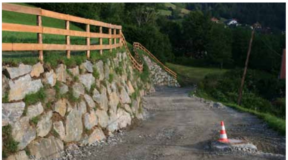
Ableitungen von Oberflächenwasser, Spreng- und Schremmarbeiten und umfangreiche Stützmauern, wie hier am Kraßweg im Jahre 2007 führten zu höheren Baukosten.
