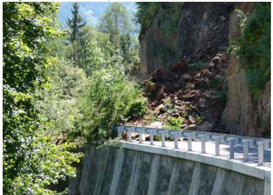
Der massive Felsabbruch beim sog. „Robnkofl“ auf die Schlaitner Gemeinde-straße erforderte längerfristige Umleitungsmaßnahmen Foto: Dominic Rindler
