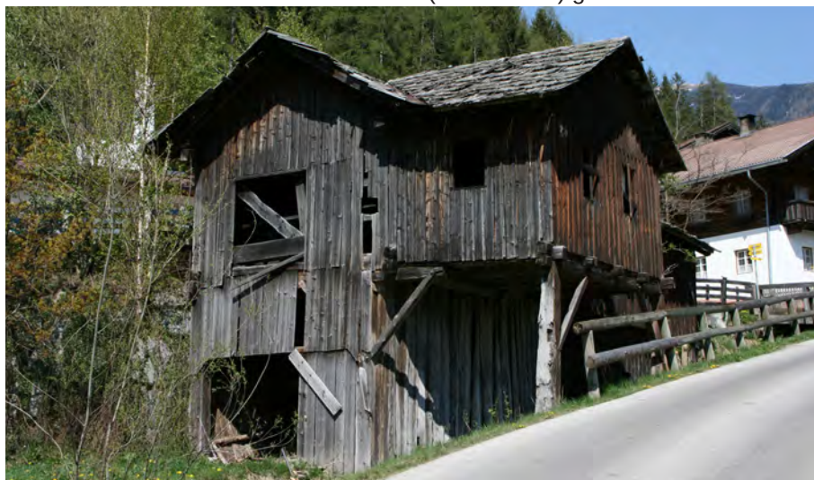
Die baufällige Säge von Oberdrum war ebenso wie die Gemeindesäge von Schlaiten mit einem der seltenen Venezianer-Gatter ausgestattet und muss abgetragen werden, weil eine Sanierung nicht mehr möglich ist. Es bestehen Vereinbarungen, verwertbare Bestandteile in Schlaiten zu verwenden.
