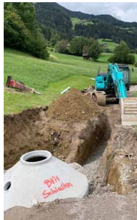
Die Oberflächenwässer werden an zwei Orten in eine Retentionsanlage DN 2500 mm eingeleitet. Im Schacht befindet sich eine Abflussdrossel und ein Notüberlauf.
