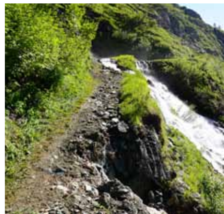
Der Regenbach (in der Karte korrekt eingetragen als Reggenbach) hat mit dem Schmelzwasser heuer wieder ziemlich Schäden an der Weganlage angerichtet. Die Sanierungskosten werden, wie in den vergangenen Jahren gemeinsam von der Bringungsgemeinschaft Hintertösen (AGM-Schlaiten), dem Deutschen Alpenverein, dem Tourismusverband und dem Nationalpark Hohe Tauern finanziert.
