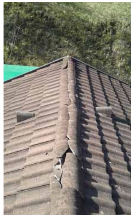
So wie bei den Gemeindegebäuden hat es nach dem heurigen Winter wohl bei fast allen Gebäuden ausgesehen. Unmengen von Dachziegel und Firstkappen wurden im Bauschuttcontainer abgegeben. Die enormen Kosten für diese Entsorgung waren Anlass, künftig einen Entsorgungsbeitrag einzuheben.
