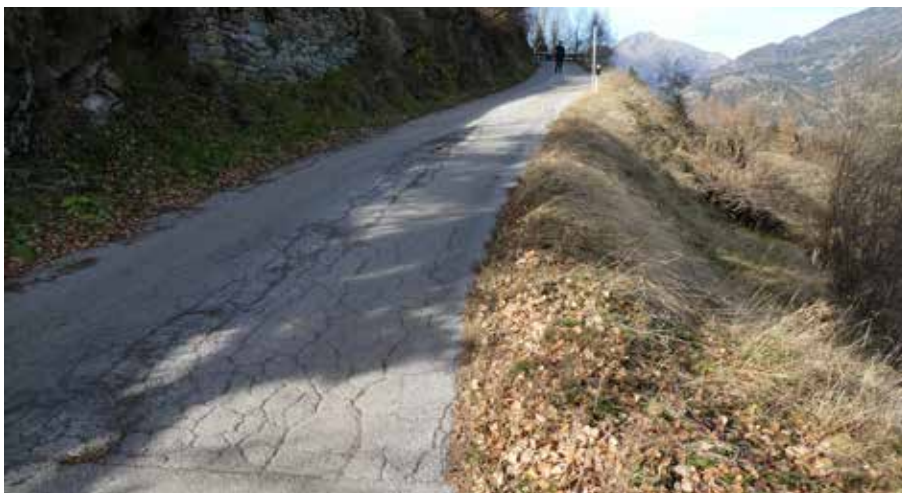
Gravierende Asphalt Schäden erfordern eine Verstärkung des Straßenkörpers mit einer Neuasphaltierung bei der Göriacher Straße.
