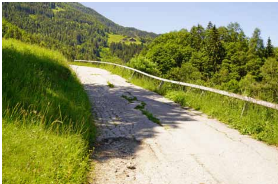
Die Schäden am Wölfeleweg waren schon einige Jahre nicht mehr zu übersehen und beim Befahren auch nicht mehr zu überhören. Mit der Sanierung musste jedoch bis zum Abschluss der Arbeiten am Gasserweg zugewartet werden.
