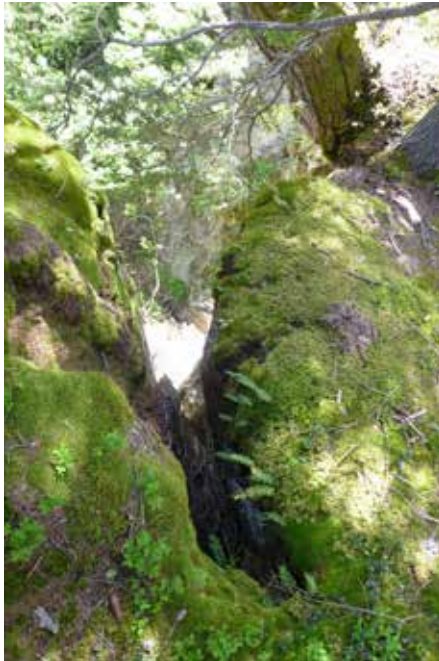
Bei derartigen Spalten müssen künftig Bewegungen durch eigene Messmethoden beobachtet werden.
